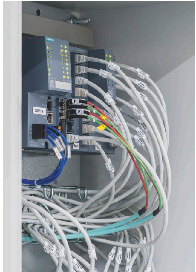
Insgesamt 95 Scalance X-Switches bilden die Schnittstellen einer Netzwerk-Struktur aus mehreren Subnetzen, zum Beispiel bestehend aus Scalance XM416-4C...
