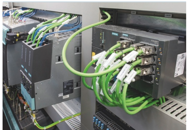
...oder Scalance X216, die hier im Schaltschrank verbaut sind.
