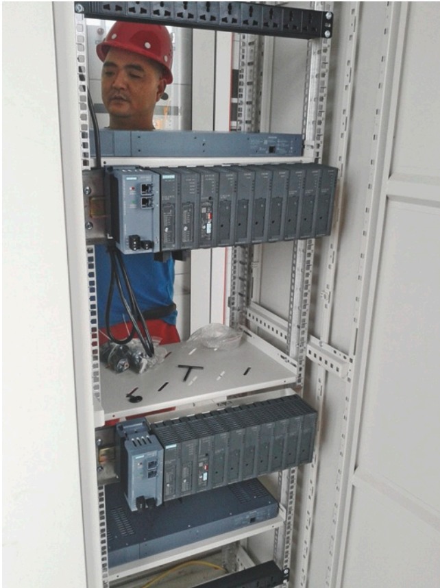
Installation von zwei Scalance Switches
