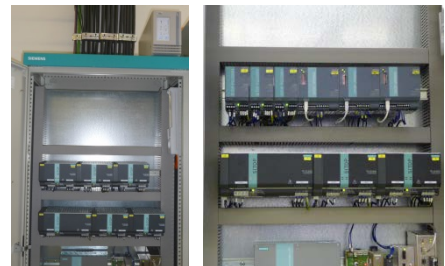
Figura 1: En este armario eléctrico de control de una instalación de grúa se ha sustituido un SAI de AC, que por su tamaño tuvo que montarse encima del armario (fotografía de la izquierda), por tres SAI de DC. Dado que además se utilizó la generación de fuentes de alimentación compactas SITOP PSU300M 24 V / 20 A, las tres fuentes de alimentación se adaptaban a las tres SITOP UPS500S 15 A / 5 kW en el mismo perfil DIN simétrico.
