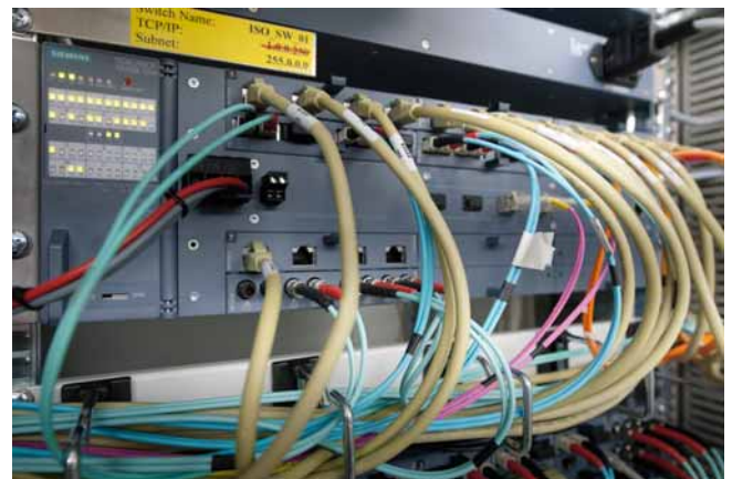
Bild 2: Redundantes 10-Gbit-Rückgrat für effiziente, bald virtualisierte Prozessführung: einer von zwei Industrial Ethernet Switches/Routern SCALANCE XR552-12M von Siemens für den Rack-Einbau.
