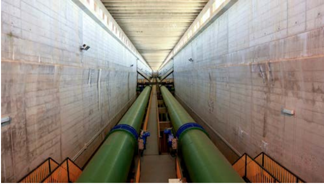
AQP ist eines der größten Wasserversorgungssysteme Europas. Mit über vier Millionen Einwohnern hat die Region Apulien die höchste Anzahl an Verbrauchern.
