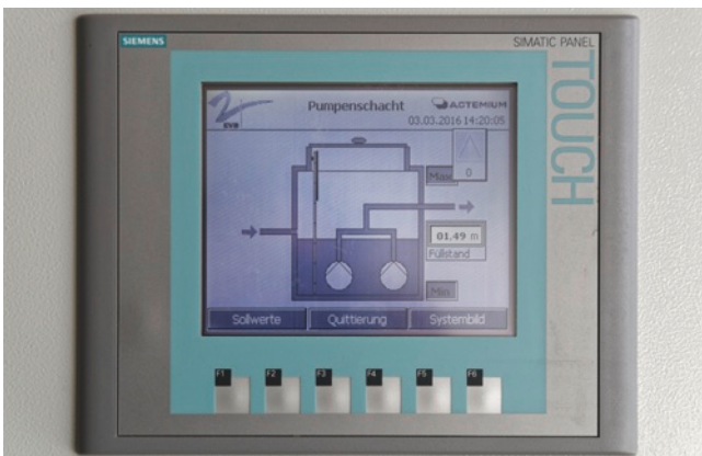
Das Touch Panel ermöglicht ein kostengünstiges Bedienen und Beobachten der Pumpstation vor Ort.
