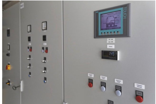
Die Steuerungs- und Fernwirktechnik befindet sich in den Schaltschränken.
