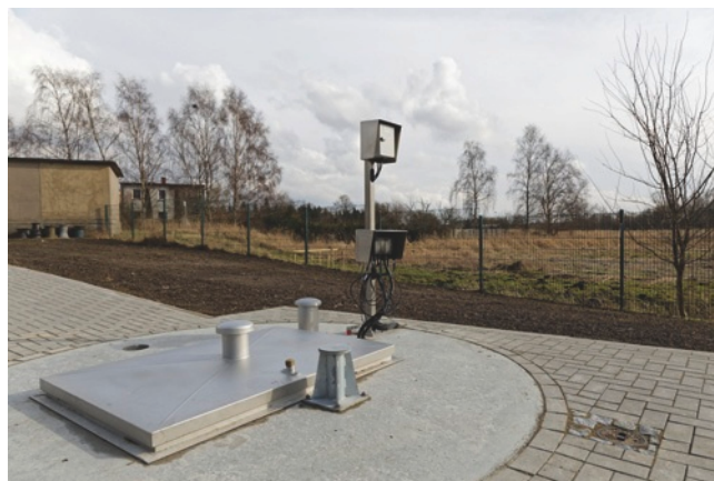
Der Standort in einem Wasserschutzgebiet macht eine besondere Überwachung dieser Pumpstation in Wismar zwingend notwendig.
