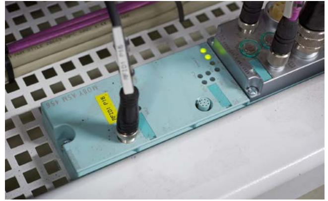
Über Anschaltmodule Moby ASM 456 sind die SIMATIC Reader RF240R via PROFIBUS an die fehlersichere Liniensteuerung SIMATIC S7-300F angebunden
