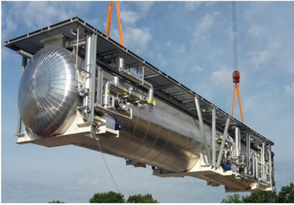
Schwebender Koloss: Im Separator wird nach der Installation „rohes“ Nassöl in die Wasser-, Gas- und Ölphasen getrennt.
