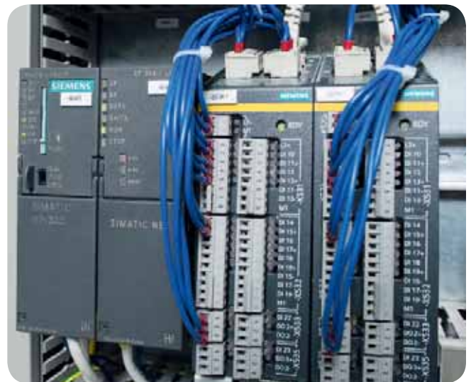
Kopf der Maschine ist eine speicherprogrammierbare Steuerung Simatic S7-300 (links) von Siemens. Zwei Sinamics Terminal Modules TM54F (rechts) begrenzen in Verbindung mit erweiterten Sicherheitsfunktionen im Antrieb sicher die Verfahrwege des Laserkopfs.
