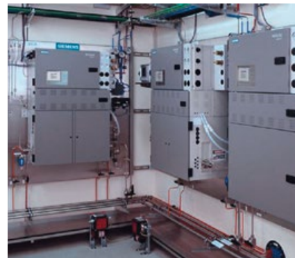
Siemens PGC in a plant.
